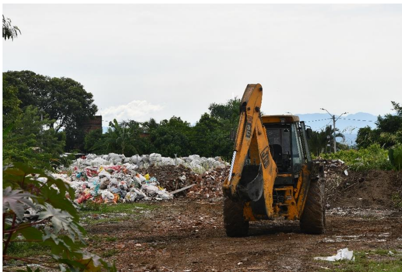
Foto 1. Relleno de excavación con desechos y escombros, sector Primavera – Asturias
